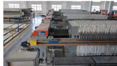
江西上饶某污水处理厂（日处理规模150000T/D）
