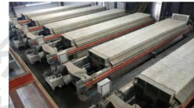
赤峰某排水公司污水处理厂（日处理规模260000T/D）
