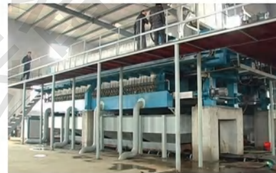
常州某污水处理厂（含水率80%污泥200T/D,处理后含水率≤60%）
