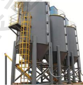
石灰投加系统 Lime dosing systems
