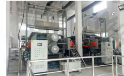
福建龙岩某污水处理厂（日处理规模150000T/D）
